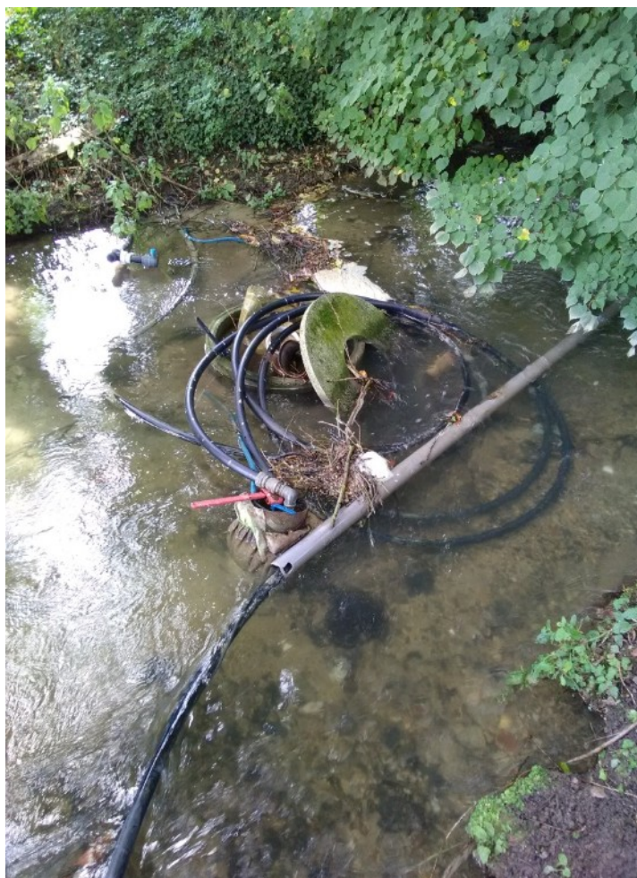
Figure 122 : installation de pompage observée sur le bassin de la Corbie (FDAAPPMA27)
